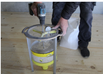
Mit Hilfe eines Akkuschaubers die Schüttung in die CLT BOX – DECKE FS einbringen
