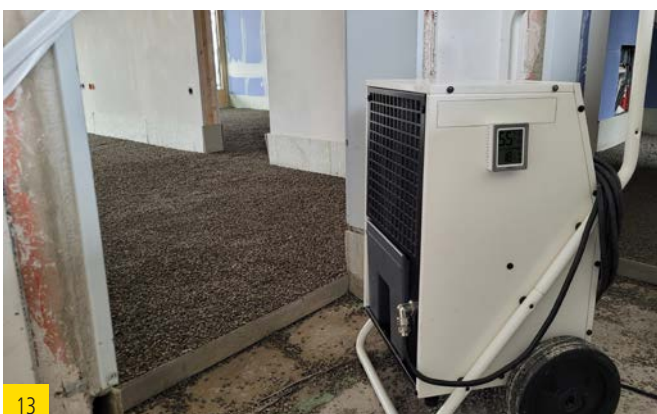
13 Um den Trocknungsprozess zu gewährleisten bzw. zu beschleunigen, kann es sinnvoll sein, Bautrockner aufzustellen.
