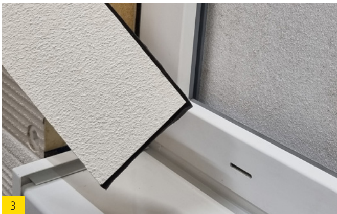
3 Laibungsplatte auf Gefälle der Fensterbank schneiden und an der kurzen und langen Seite best wood Fugendichtband Typ 12/3-7 anbringen.
