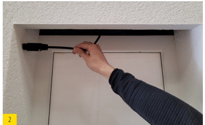
2 Das Kabel ist vorbereitet und mit einem Hirschmann-Stecker versehen. Kabellänge = 1/2 Fensterbreite
