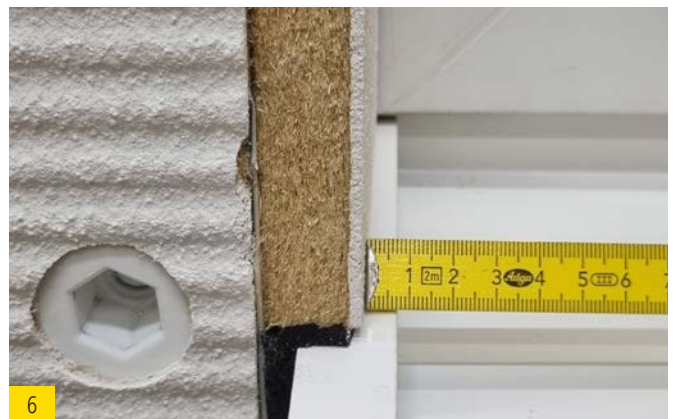
6 Der Schenkel des Fensterbankendstückes sollte noch ca. 7 mm für den weiteren Putzaufbau vorstehen. Bei nicht vorverputzten Laibungsplatten ca. 10 mm
