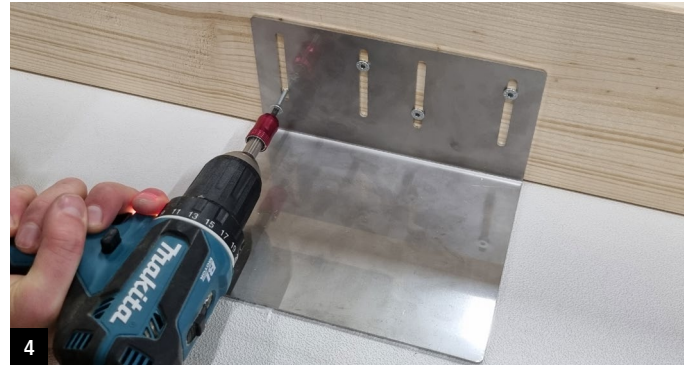
4 Winkel im Riegel verschrauben. Anmerkung: Bei Plattenstößen ist im Bereich des Stoßes ebenfalls ein Winkel vorzusehen
