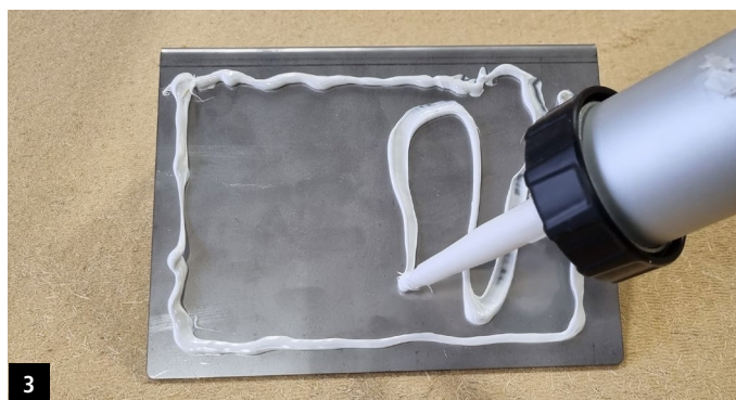
3 Appliquer FDM WALL sur l'équerre et la presser à l'arrière du LAMBREQUIN (pour les distances de mise en œuvre)
